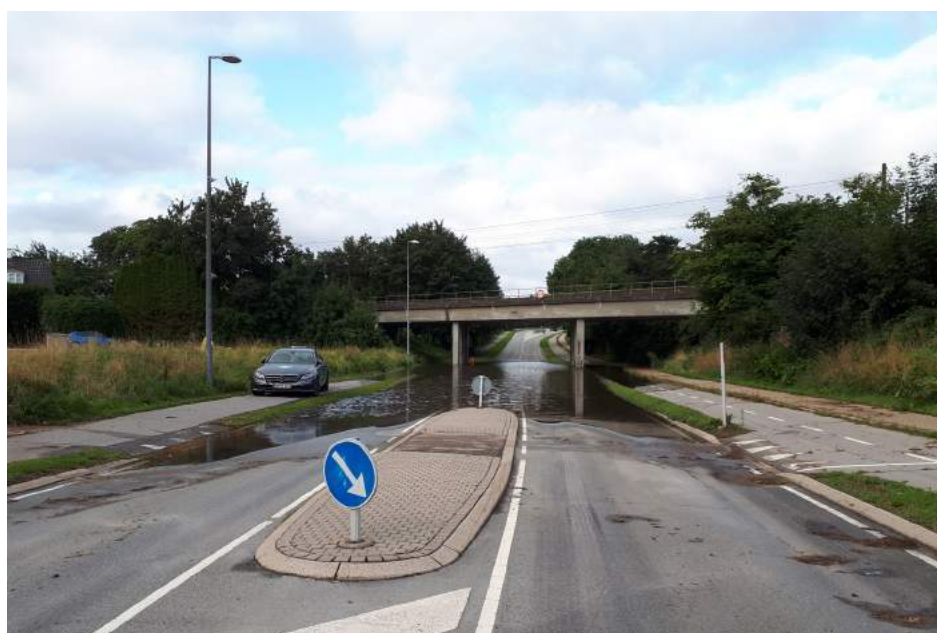
Hvor jernbanen krydser Hornbækvej, opstaves der ofte meget vand ved skybrud, da terrænet ligger lavt. Foto: Helsingør Kommune.
